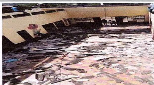
Foto 4: techo destrozado de toda la escuela
